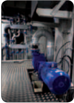
All Pumps is een allround leverancier van pompen en appendages. Op de foto de pompen en afsluiters in de machinekamer van de Anklajo, een schip dat Kuipers Scheepvaart binnenkort oplevert aan Vos Shipbuilding. (Foto: Guus Dubbelman)
